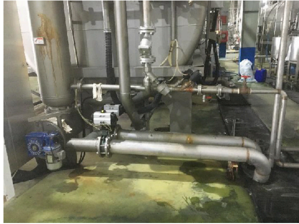
Hình 8. Bộ trao đổi nhiệt và đường ống dẫn nước giải nhiệt về bể chứa để tuần hoàn
