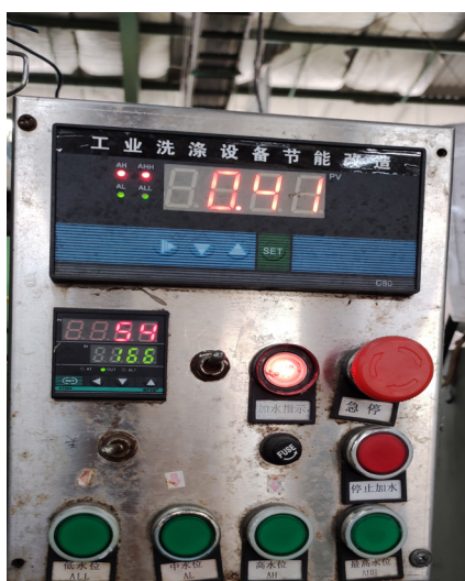
Hình 6. Hệ thống cấp nước tự động 4 cấp ở nhà máy
