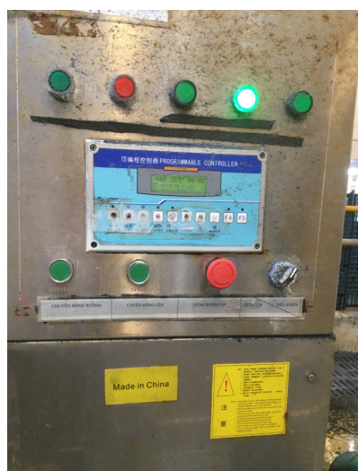
Hình 7. Bộ điều khiển cấp nước tự động ở nhà máy
