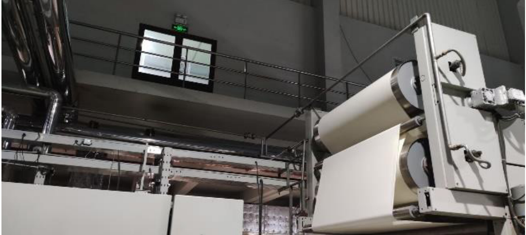
Hình 11. Đường nước giải nhiệt máy căng định hình
