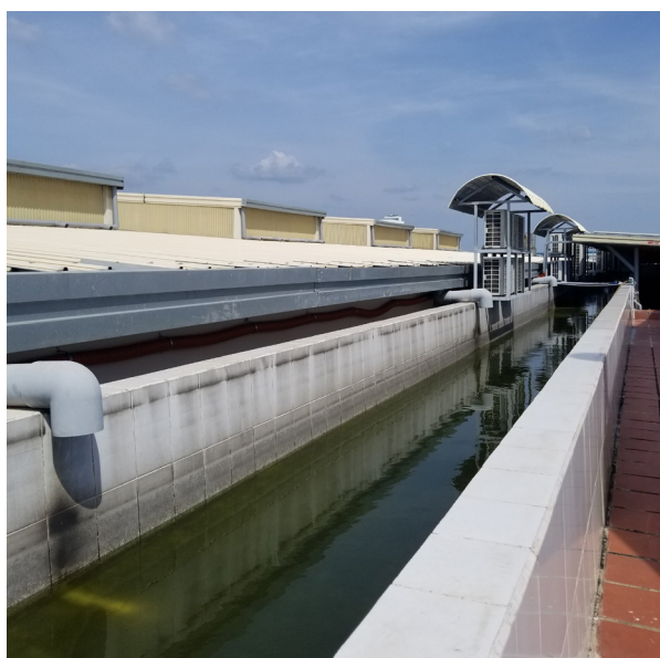
Hình 34. Hệ thống đường ống và bể bê tông thu gom nước mưa trên tầng thượng
