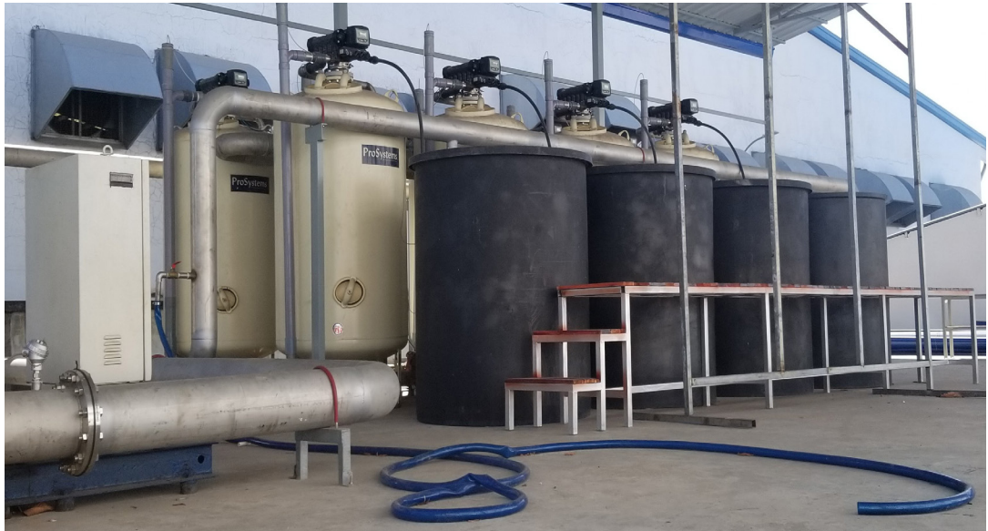
Hình 35. Hệ thống lọc nước mưa tại nhà máy điện hình
